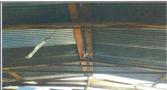
Foto 3: CAMBIO DE LAMINA EN MAL ESTADO POR LAMINA TROQUELADA
